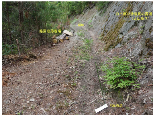
向こうの55m地点は路肩が崩落しています。
